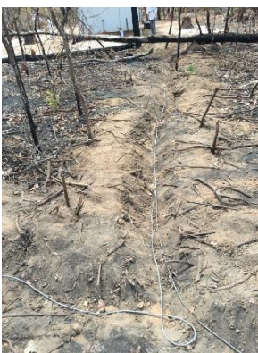
<写真 4: 地中に埋められたケーブル>
